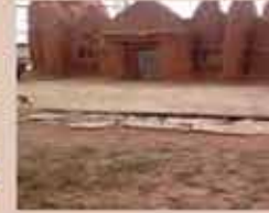
Photo illustrant le décapage du revêtement en ciment de la terrasse de la mosquée de Kouto (octobre 2022)
