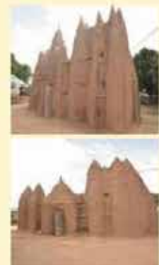
Photos illustrant l'état de conservation de la mosquée de Kouto après les travaux (Octobre 2022)
