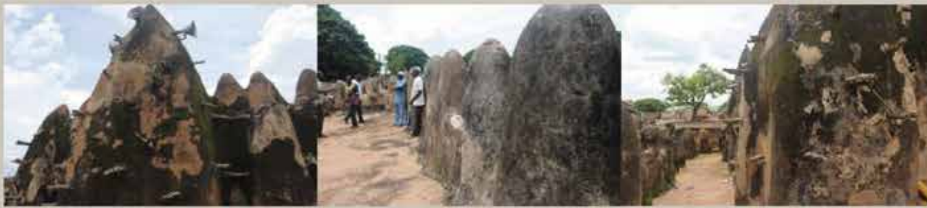
Photos illustrant l'état de conservation de la mosquée de Kaouara avant les travaux de restauration
