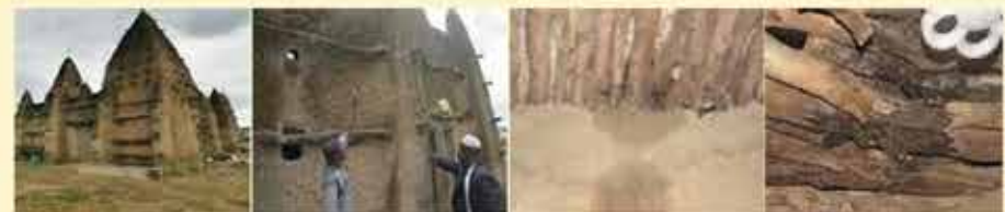
Photos illustrant l'état de dégradation externe et interne de la petite mosquée de Kong avant les travaux de restauration Source : Secrétariat Exécutif de gestion des Mosquées de style soudanais du nord ivoirien
