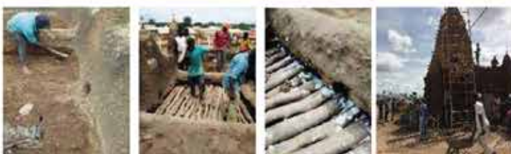
Photos illustrant les travaux de réhabilitation du toit-terrasse et des façades de la petite mosquée de Kong (septembre 2022)
