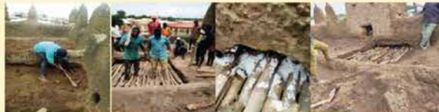
Photos illustrant les travaux de réhabilitation du toit-terrasse de la petite mosquée de Kong (Septembre 2022)
