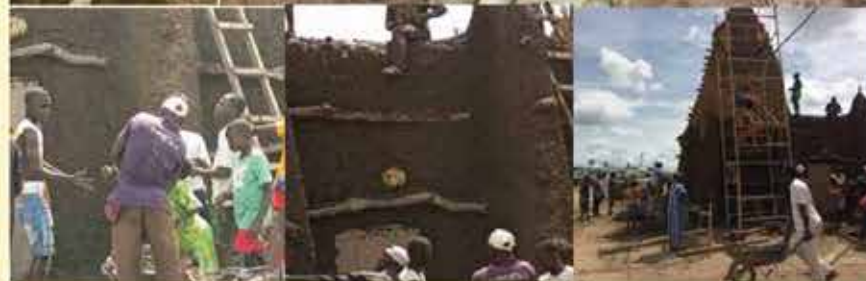
Photos illustrant les travaux de réhabilitation des façades de la petite mosquée de Kong (Septembre 2022)
